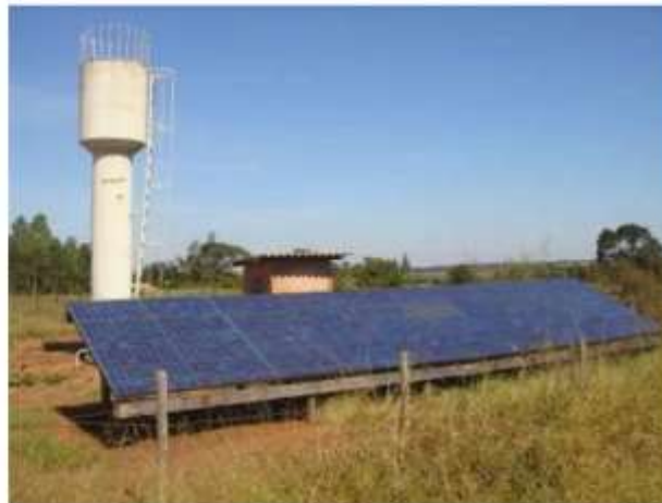
Bombeamento, Projeto LSF-IEE, ITESP, Presidente Bernardes, SP Bomba e condicionamento de potência de fabricação nacional
